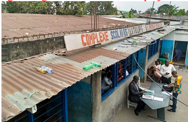
Nu moet nog dit dak vernieuwd.
